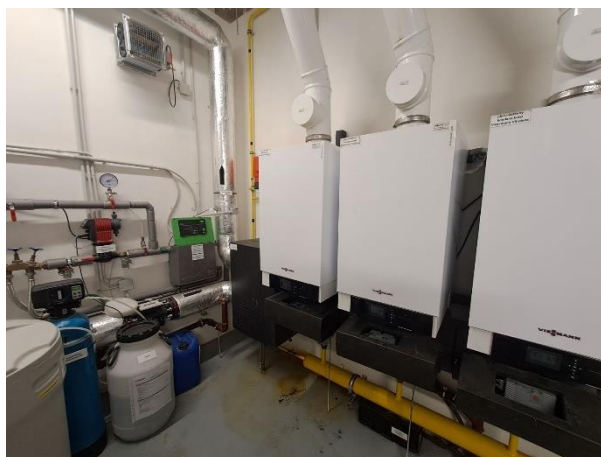
Obrázek 10: Příklad plynové kotelny v objektu F37
