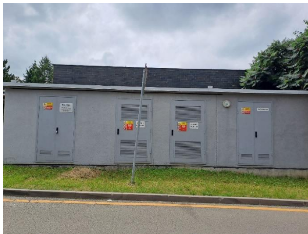
Obrázek 9: Příklad kioskové trafostanice (pro objekty C2, C3, C4, C6) vlevo,
