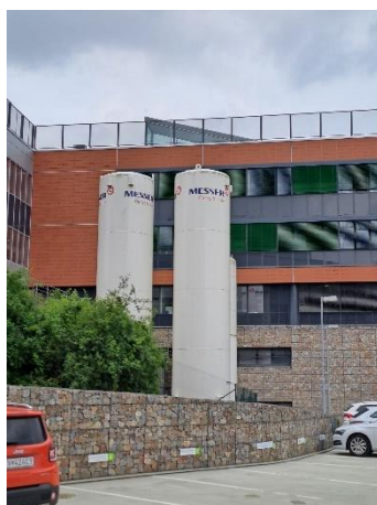
Obrázek 11: Příklad sil s technickými plyny u objektu D30
