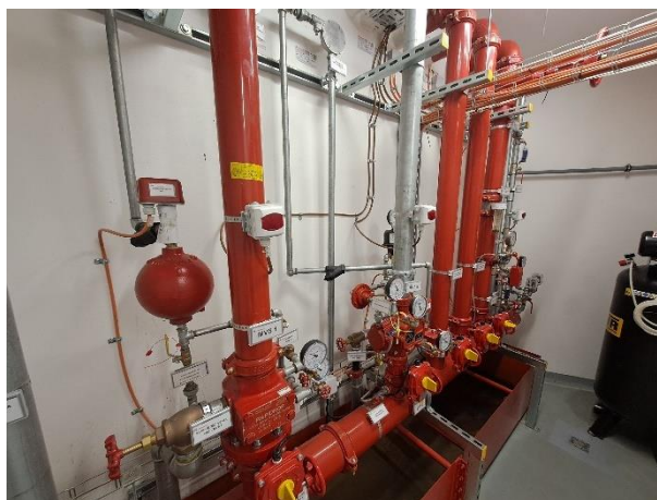
Obrázek 6: Příklad ventilové stanice v objektu F37
