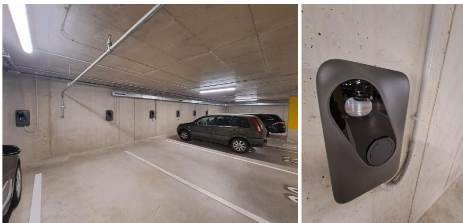
Obrázek 8: Nabíjecí místa v podzemních garážích objektu F37 (doposud mimo provoz)
