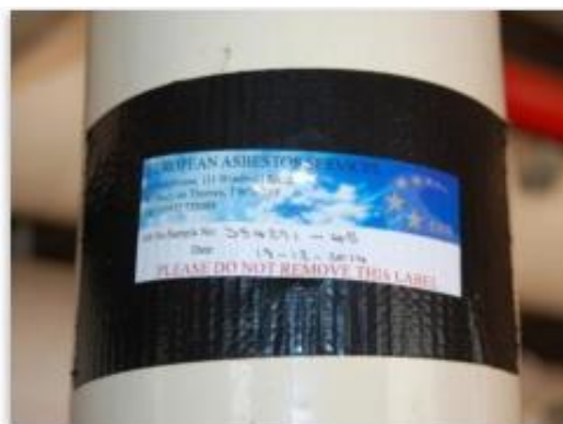
Potrubí obsahující azbest, Zdroj: UEPG
