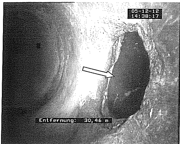
FOTO 005: 30,3m - zaústění, v horní části
