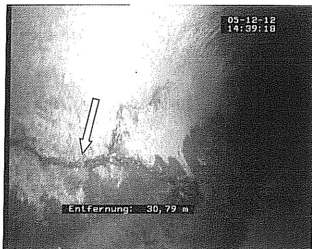
FOTO 006: 30,5m - netěsnost, paprskovité trhliny, celkový obvod v úseku 30,5 - 31,8m, exfiltrace
