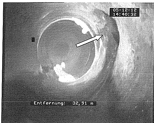
FOTO 007: 32,5m - zaústění, v horní části
