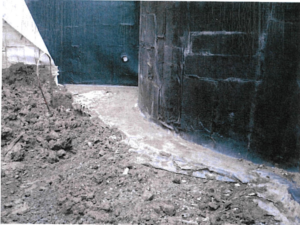
Obr. 1: Přetažené podkladní betony u jižní rotundy NMR pavilonu A4
