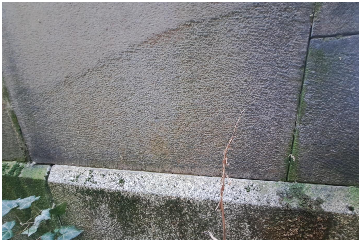
Trhlina v zadní straně pohledově levého sloupku
