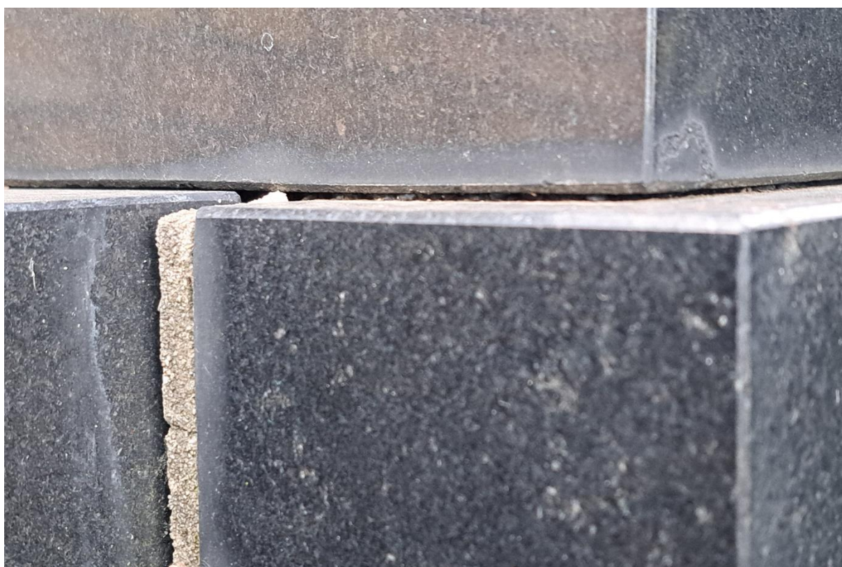
Poškozené spárování mezi bloky architektury
