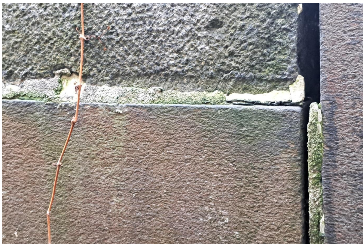
Poškozené spárování Zadní strana náhrobku Stav v březnu 2024
