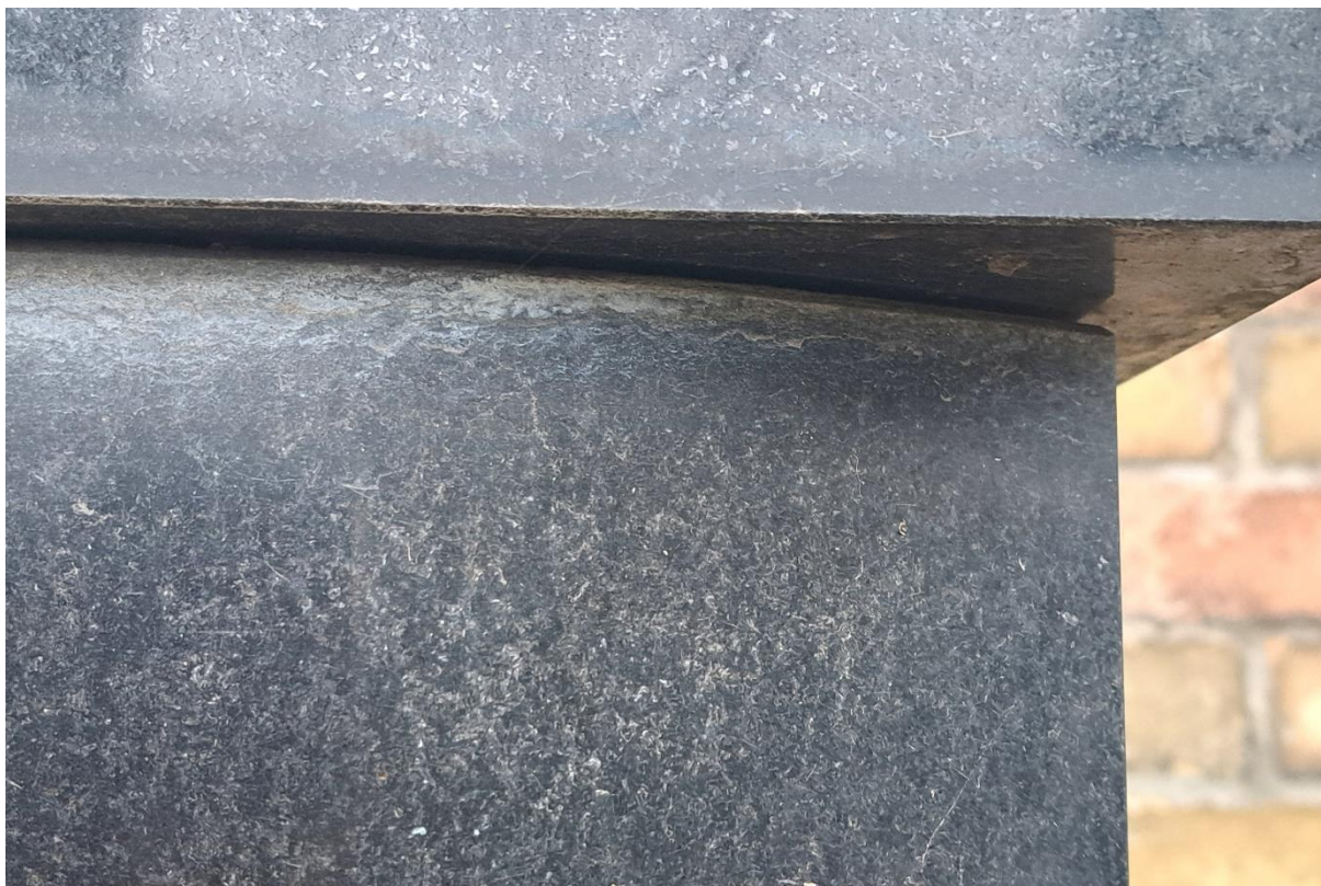
Krusta pod hlavicí pohledově levého sloupku
